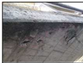
措置が必要な状態
