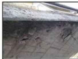
措置が必要な状態
