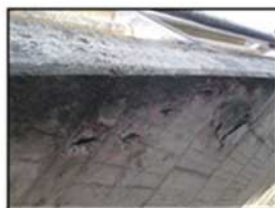
措置が必要な状態
