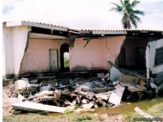
ハリケーン直撃後の被害
