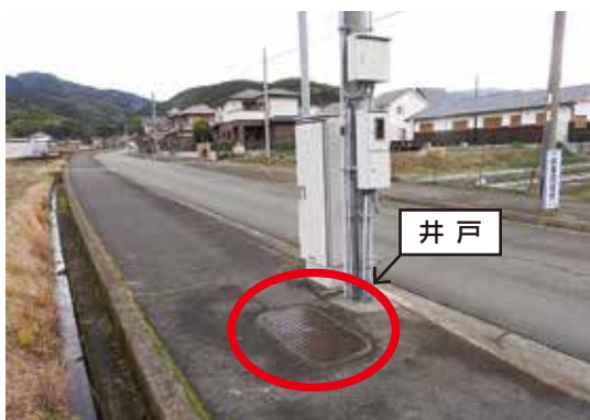
井戸と井戸ポンプの制御盤（東久原）
