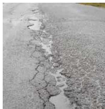
非常に傷んだ舗装箇所
