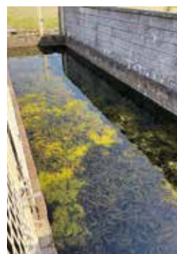
木寄組合 防火水槽
