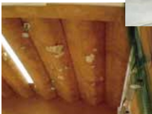
◀山田小学校体育館の天井壁
