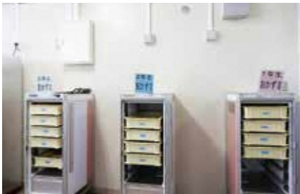
▲弁当給食保管室
