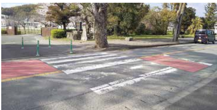
横断歩道の表示が消えかかっている山田小学校付近
