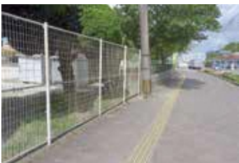
腐食が目立つ久原小学校フェンス
