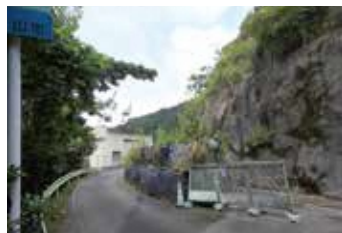
猪野ダム周回道路の法面崩壊箇所
