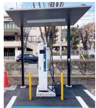
大野城市役所北駐車場 EV 急速充電設備
