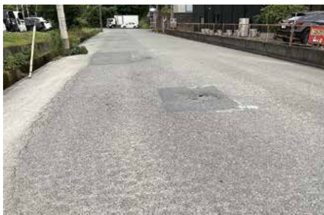
ひび割れと補修跡がある傷んだ舗装
