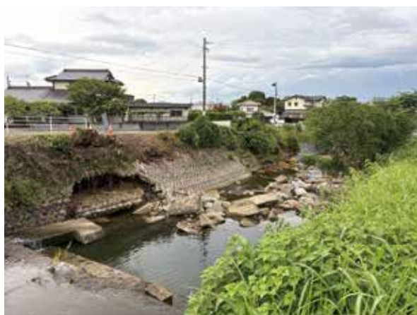
下久原横手橋下流左岸の被害状況
