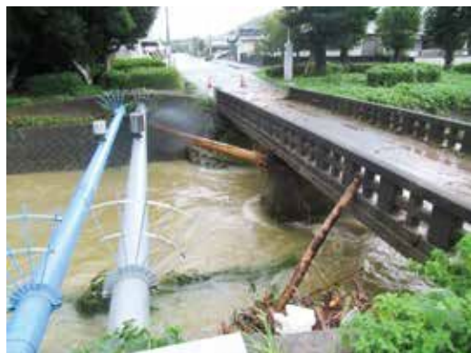
猪野原橋の被害状況
