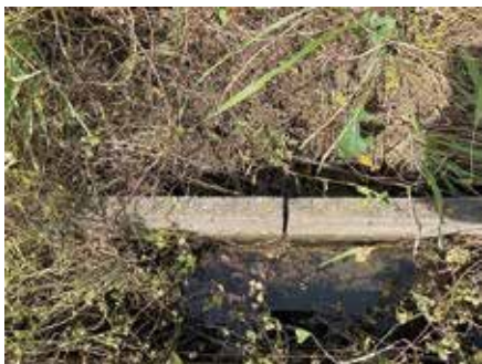
水路の継ぎ目からの水漏れ
