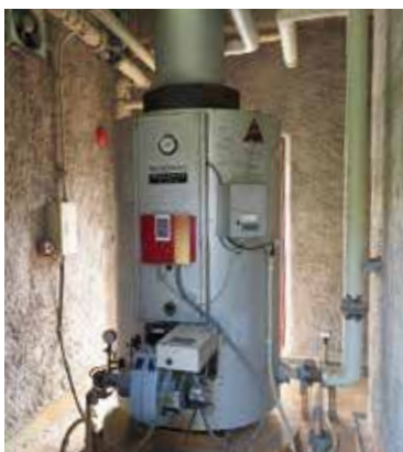
温水ボイラー
