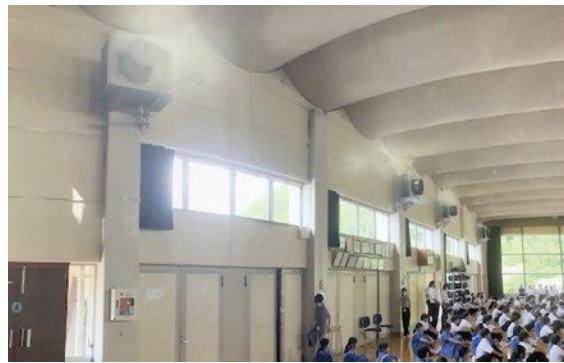
久山会館2階講堂での1学期終業式の様子 (エアコン 4台)
